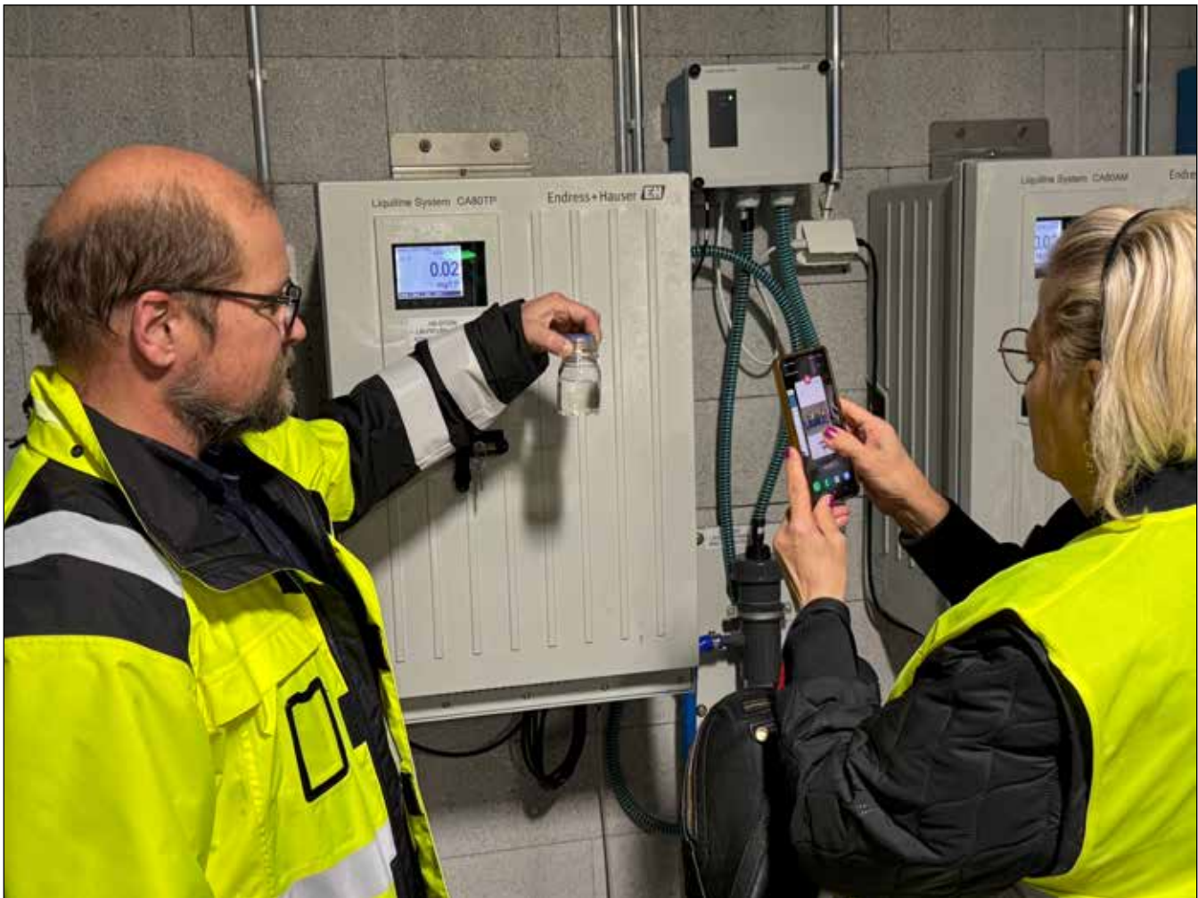
Tarkastuslautakunta tutustui 22. lokakuuta 2024 Metsä-Sairilan jätevedenpuhdistamoon. Vesiliikelaitoksen johtaja Jarkko Laitinen ja lautakunnan jäsen Katariina Asikainen voivat hyvillä mielin todeta, että puhdistetun veden laatu on hyvä. Kuva: Jukka Vuorio
